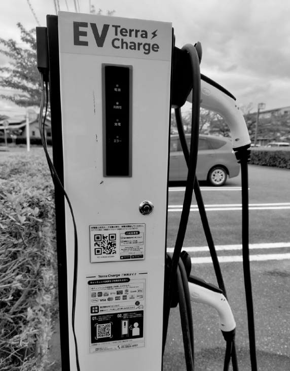
EV 普通充電器（宮代町役場駐車場）
