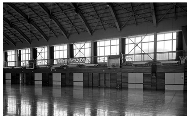
避難所となる体育館に設置されたエアコン（百間中）
