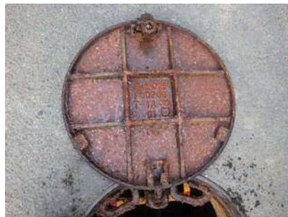
管路施設（マンホール蓋の劣化）
