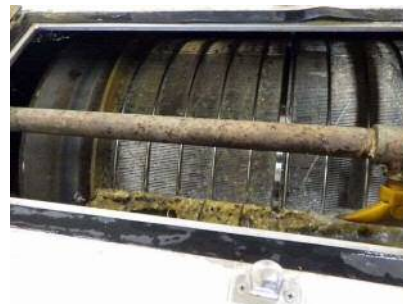
処理施設（機械設備の劣化）
