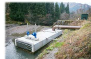
小水力発電施設
