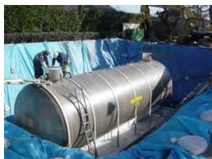
耐震性貯水槽
