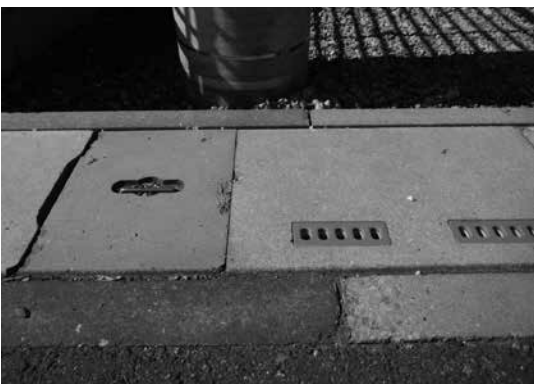
最近の側溝は、重く、開かない
