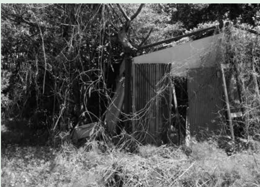
ひどい状態になっている空き家
