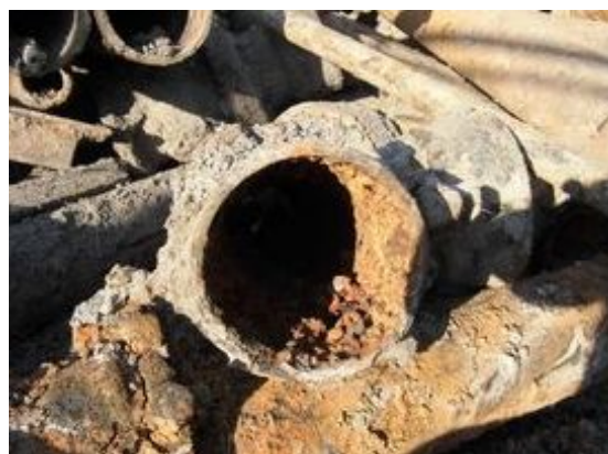
【老朽化した水道管】
