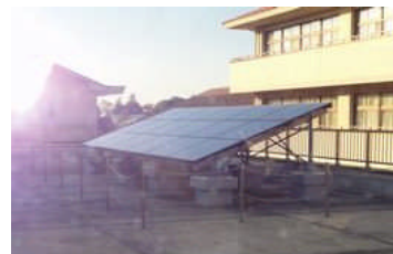
屋上の太陽光パネル
