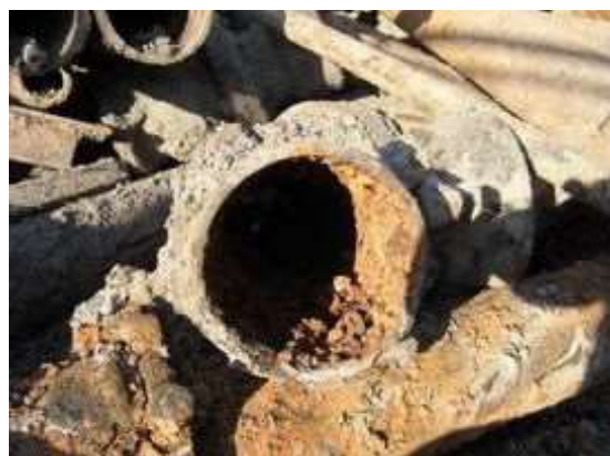
【老朽化した水道管】
