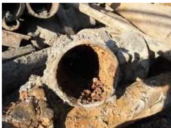
【老朽化した水道管】
